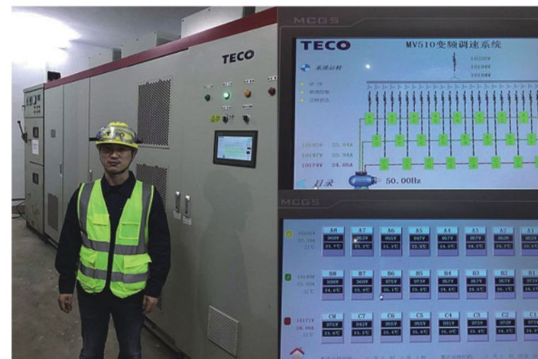
▲ 现场高压马达变频器调试
